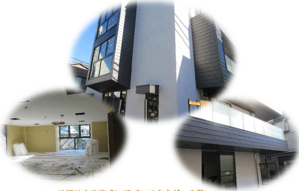
外観は大分完成に近づいていますが、内装は、現在進行中です!!
